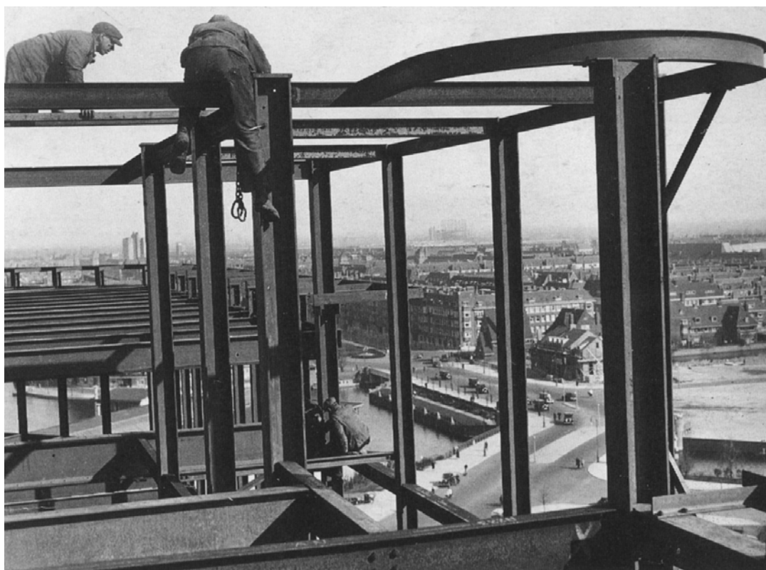
Afbeelding 4.1.87: de montage van de staalconstructie op grote hoogte. Mens, R., De Sociale Verzekeringsbank. Architectonische Aspecten , Amstelveen 1991.
