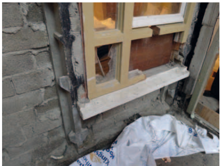
AFB.15. Destructief onderzoek van kozijnen in de achtergevel van de proefwoning, 2010 (foto Hielkje Zijlstra)
