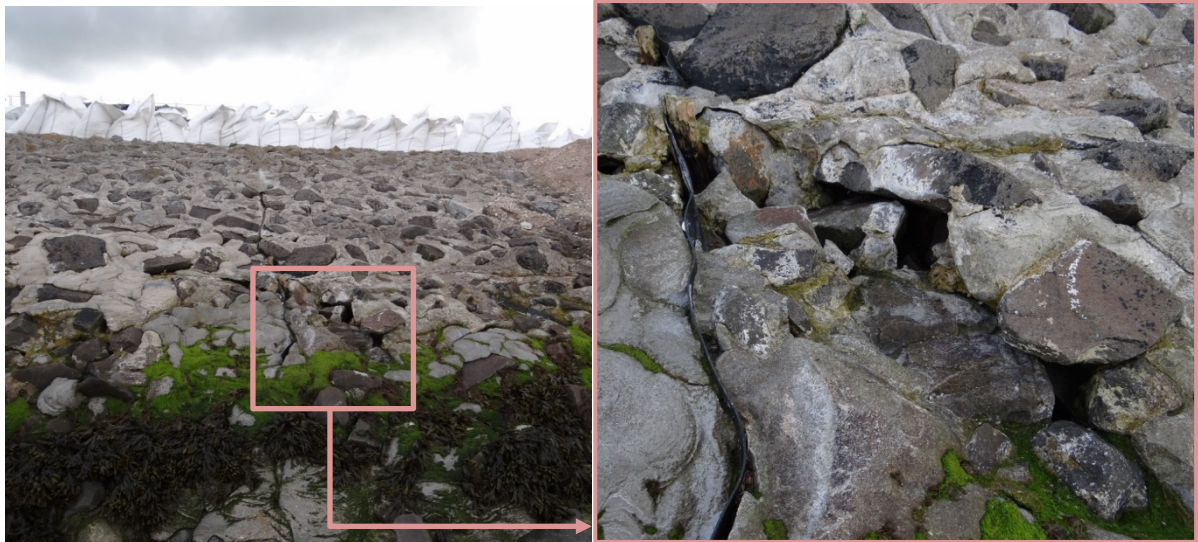
Abbildung 25: Lokale Absackung der Deckschicht am Voslapper Groden (Fotos: Kreyenschulte 2016).
