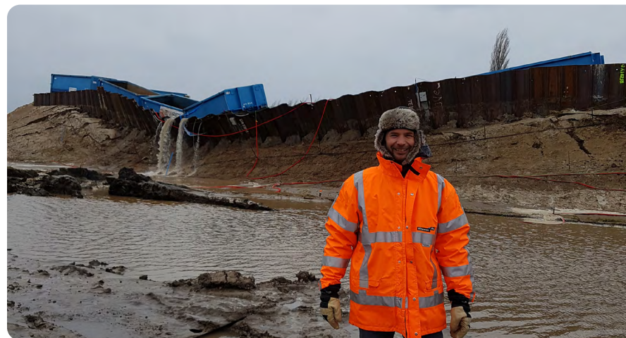
Figuur 2: Eemdijk-damwandproef na bezwijken. Foto door Arny Lengkeek.
