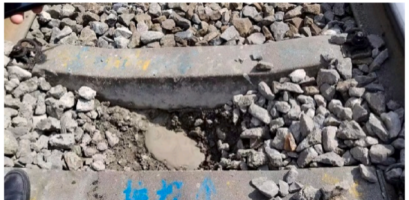
Fig. 18. Ballast layer fouling.
