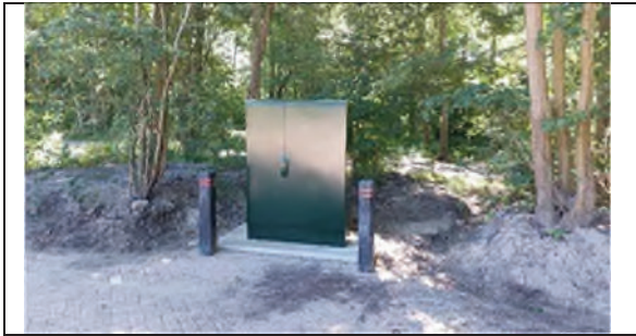
Definitieve centrale elektra-/instrumentenkast
