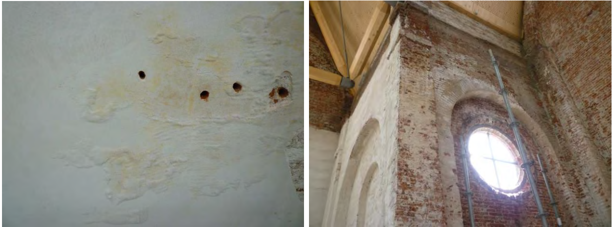
Figuur 2: Zoutuitbloei op de pleisterlaag (zuidgevel, naast de losgekomen pleister) (links) en op het nog niet gepleisterde deel van het metselwerk (rechts)
