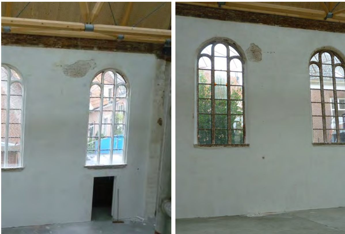
Figuur 1: Loskomen van de pleisterlaag aan de binnenzijde van de zuid- (links) en noordgevel (rechts)
